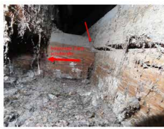
Bild 8: Die Klüftungen am nicht zugelasteten Anschluss zwischen Zerrbalken und deckengleichen Unterzügen zeigen die Wirkung der horizontalen Dachschubkräfte auf.
