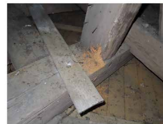
Bild 24: Schädigung eines Sparrenfußpunkts im Turmhelm
