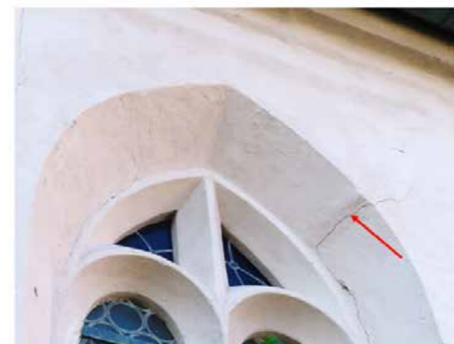
Bild 1: Rissneubildung im Fensterbogen der nördlichen Traufwand
