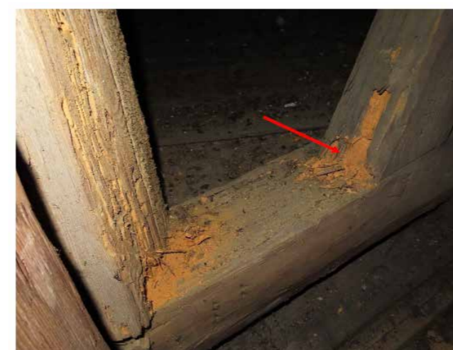
Bild 22: Schädlingsbefall in der Dachkonstruktion des Turms
