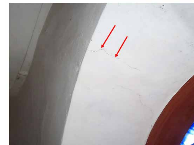
Bild 3: Risse in der Fensterachse innen
